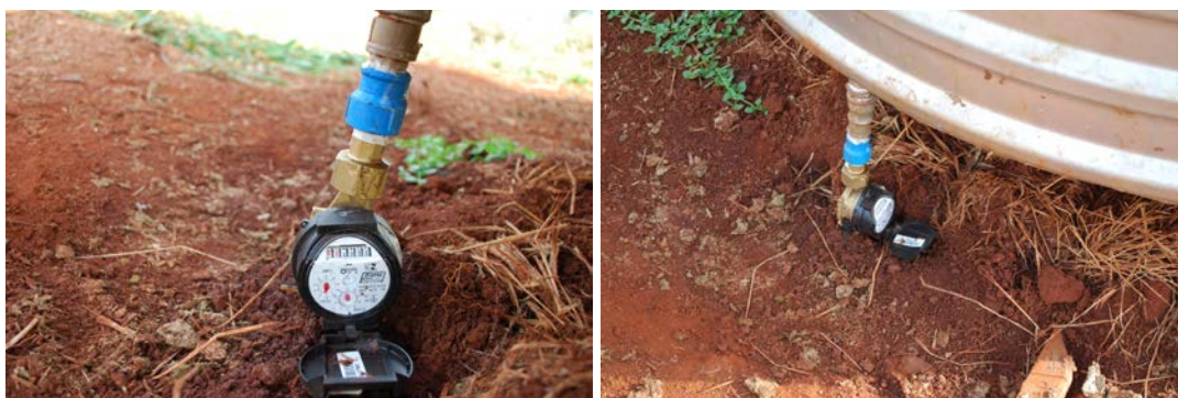
Hidrometros para aferição do consumo de água pelo lote
